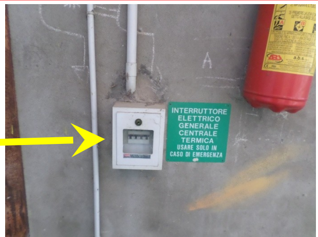
particolare interruttore elettrico centrale termica
