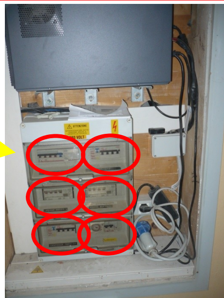
particolare interruttori NB: occorre abbassare tutti gli interruttori
