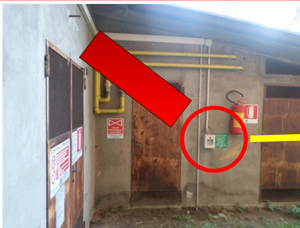
CENTRALE TERMICA (cortile nord-ovest piano Via G. Bruno)
