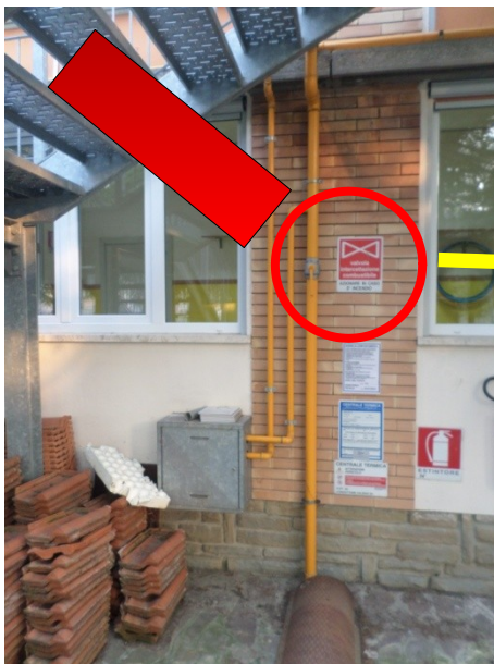
centrale termica (retro fabbricato cortile zona collegamento verso palestra)
