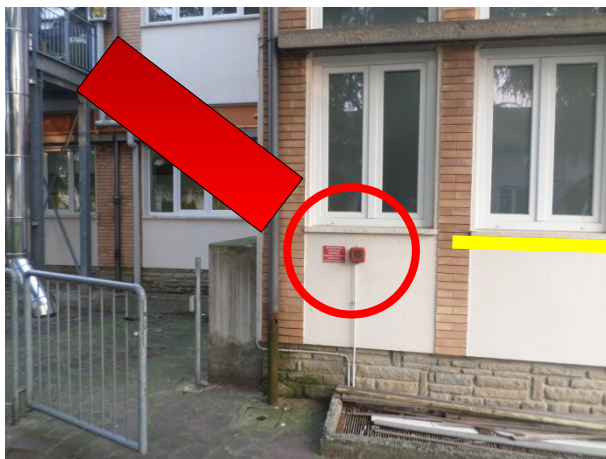
CENTRALE TERMICA (cortile zona collegamento verso palestra)
