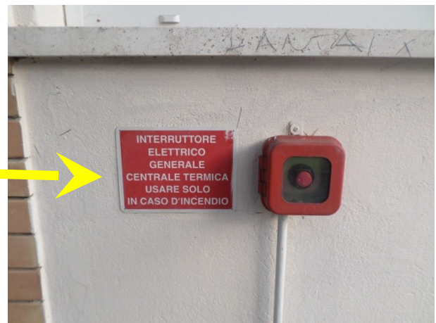
particolare pulsante di sgancio centrale termica
