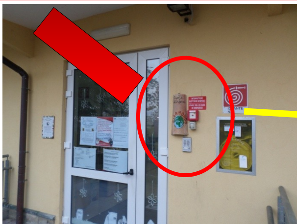
SGANCIO ELETTRICO GENERALE SCUOLA DELL'INFANZIA (ingresso principale scuola)
